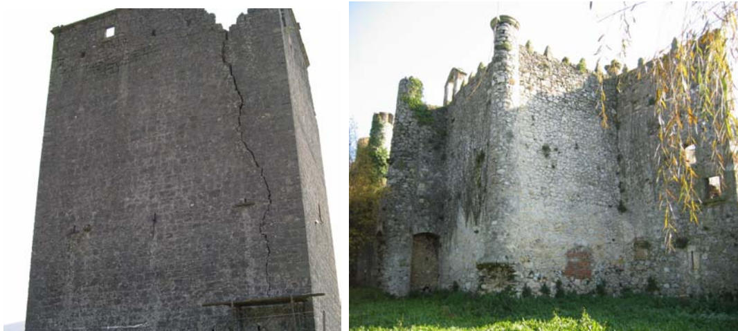
Figura 2: Daños en los muros portantes de dos antiguos edificios y que en los estudios previos a su rehabilitación habrá que proceder a su análisis, diagnóstico y terapéutica.
