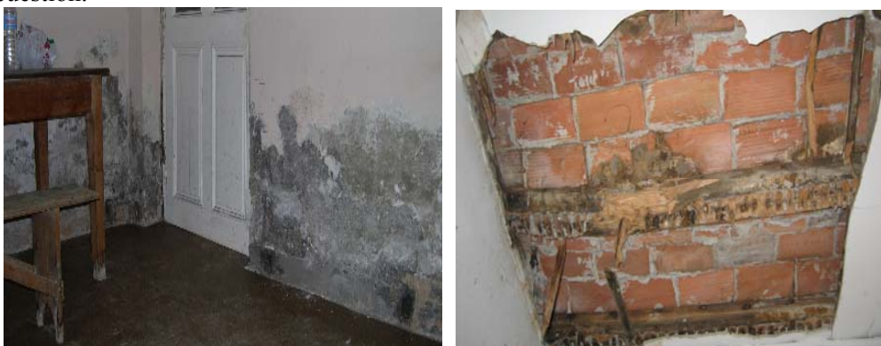
Figuras 11 - Defectos existentes en una obra objeto de rehabilitación, después de algunos años sin uso y sin mantenimiento alguno: A la izquierda pueden observarse importantes humedades de capilaridad, provenientes del terreno, en los muros. La imagen de la derecha muestra la pudrición por humedad y el colapso parcial de un forjado de viguetas de madera y bovedillas de ladrillo.
