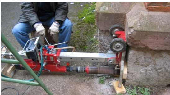
Figura 14 - Extracción de testigos de piedra de un sillar de un muro portante
