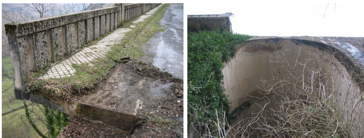
Figuras 12 - Voladizo existente (izquierda) sobre una arcada de bóvedas de hormigón (derecha): La estabilidad a vuelco de aquél no era adecuada y una parte del mismo ha colapsado (se aprecia en ambas imágenes) por falta de equilibrio estático.
