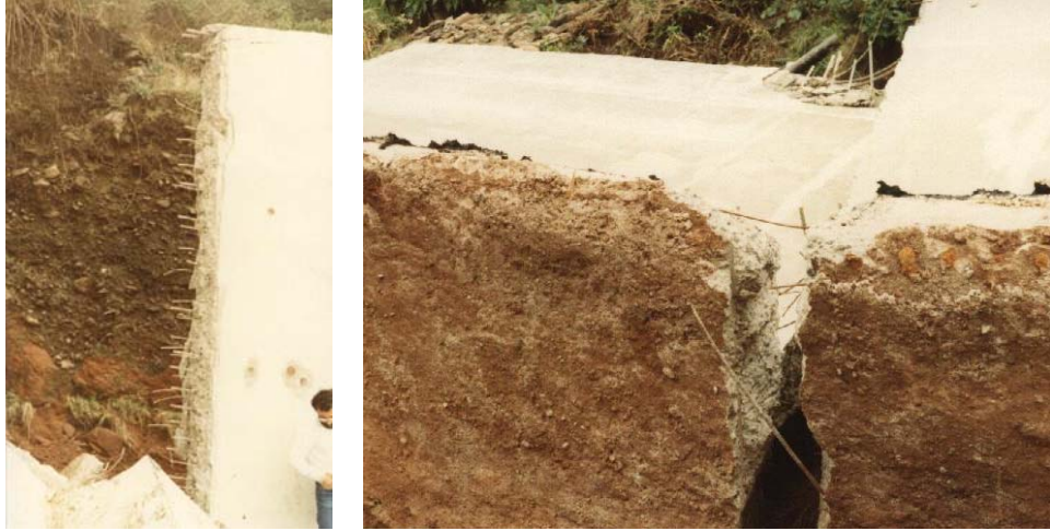
Fig. 4: Colapso de un depósito de hormigón armado por incumplimiento de las condiciones de equilibrio.
