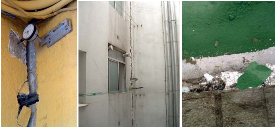
Fig. 2: Desplazamientos en el edificio afectado: Se midieron desplomes de 7 cm y descensos de 5 cm.
