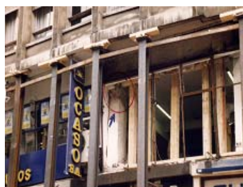
Fig. 10: Apeos de seguridad tras el colapso repentino de dos pilares de la planta entresuelo de un edificio mientras se ejecutaban trabajos de cimentación en un solar medianero: Los vecinos fueron desalojados del inmueble.
