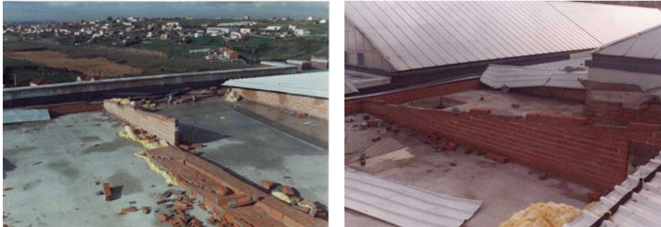
Fig. 6: Destrucción de una cubierta por efecto de la acción del viento y a causa de un incorrecta concepción del anclaje de la estructura portante.
