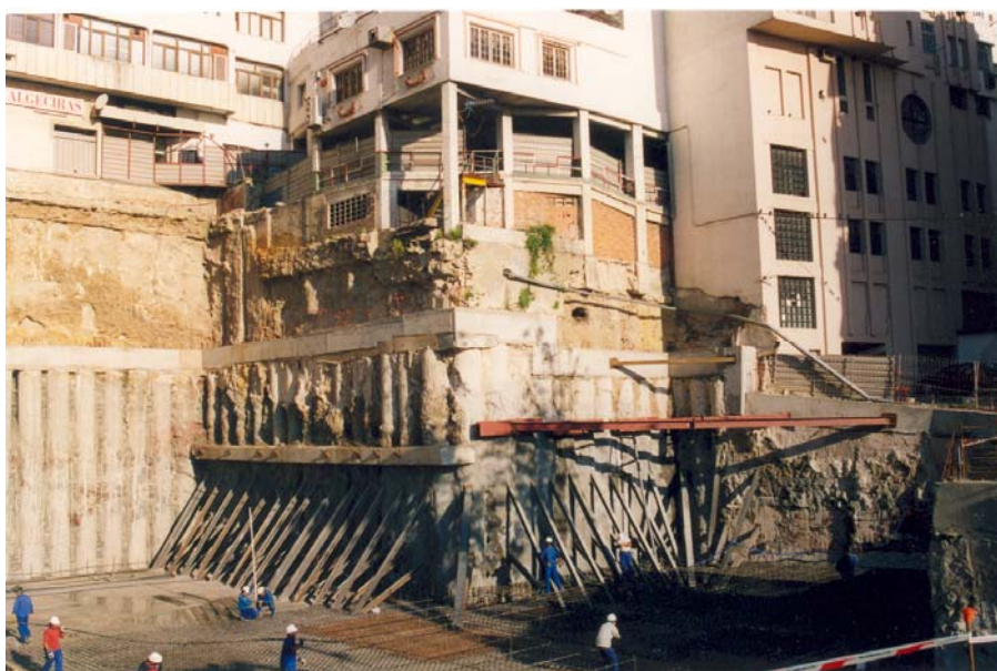
Fig. 1: Edificio de viviendas junto a un vaciado de tierras mal planteado: Durante la ejecución de las obras, el inmueble existente mostró importantes anomalías; los daños que aparecieron provocó la alarma los vecinos y que éstos fueran desalojados por algún tiempo.
