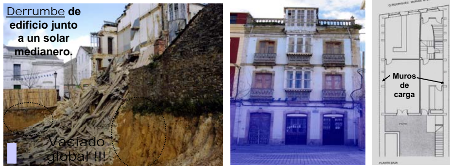
Fig. 17: Derrumbe de un edificio de 100 años y muros de carga de piedra.
