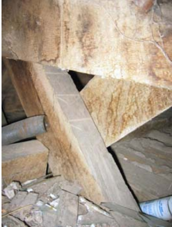
Detalle de la viga en celosía que conforma las jácenas de carga
