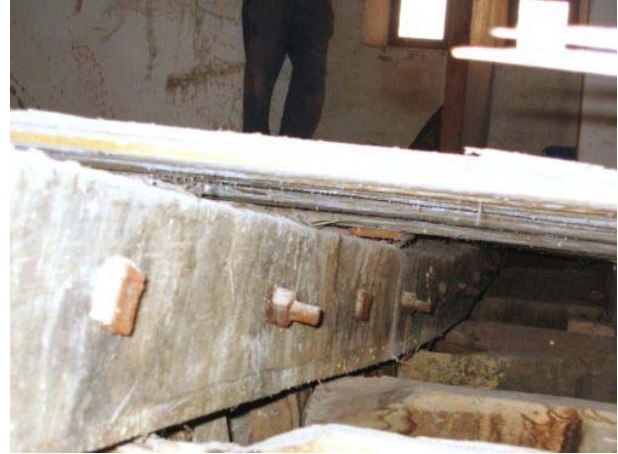
Pandeo lateral del cordón superior a compresión de una de las dos jácenas de carga
