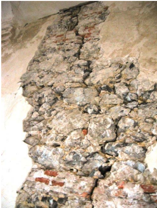
Agrietamientos y cata en el muro Oeste del cajón Este. Descansillo entre 2ª y 3ª planta.
