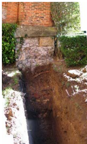
Figura 33: Calicata para conocer las condiciones de cimentación de un muro. Cortesía: TRIAX.
