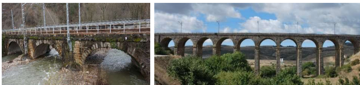
Fotografías 31 y 32 (LV): Dos puentes ferroviarios del siglo XIX en Cantabria: El de Las Fraguas (izd.) y el de Celada Marlantes (dcha.).
